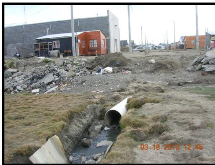
Fig. 4. Drenaje de cloacales al río. Año 2008
